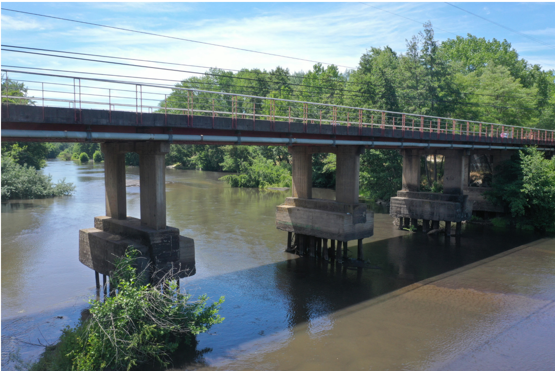
Fotografía tomada en terreno del Puente Río Claro, comuna de Yumbel, Región del Biobío. Se observa un fuerte grado de socavación y exposición de fundaciones.
