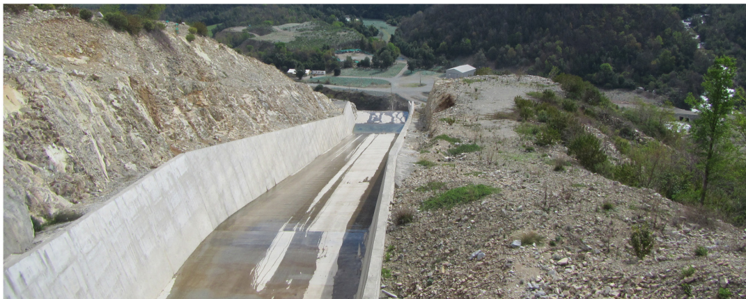
Obra de evacuación de crecidas del Embalse Ancoa. Específicamente se observa el rápido de descarga que finaliza con una obra de disipación tipo salto de esquí, visto desde aguas abajo.
