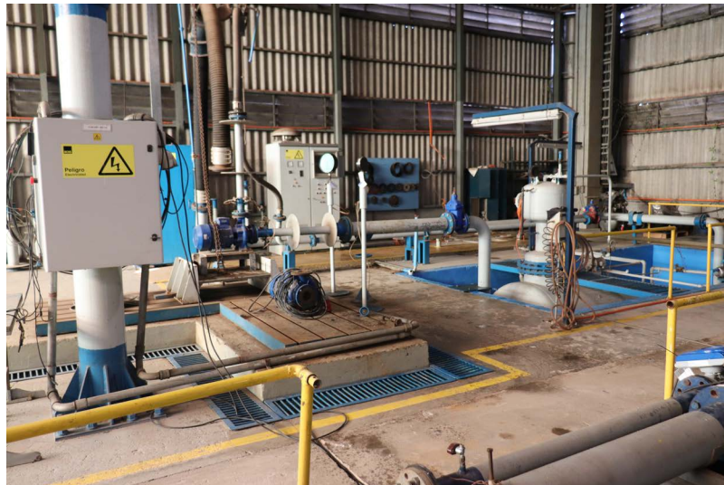
Banco de ensayo de bombas centrífugas horizontales.
